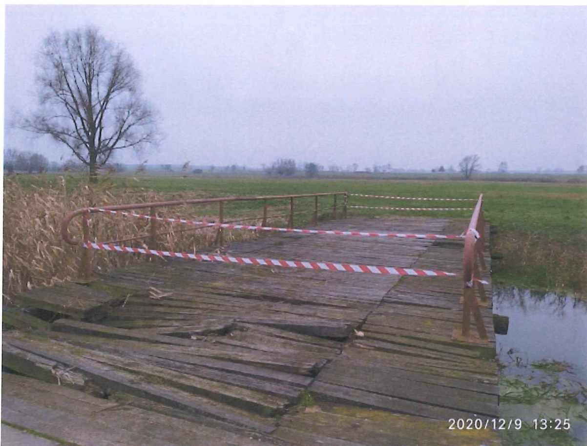
Zdj.1. Ilustracja zdjęciowa mostu w km ok. 13+396 Kościańskiego Kanału Obry na działce nr 179 obręb Katarzynin
